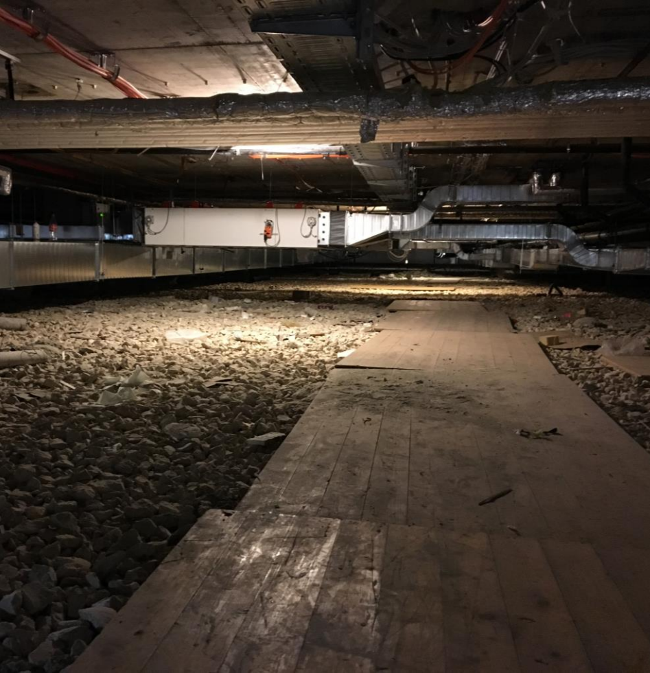
NwT-Bereich, Zugänglichkeit Lüftungsgeräte
