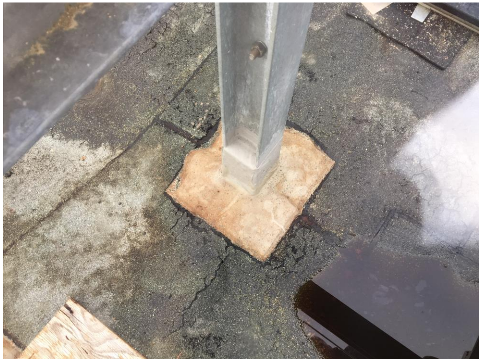
Wassereintritt / Schäden am Bitumen und der Stützen-Eindichtung
