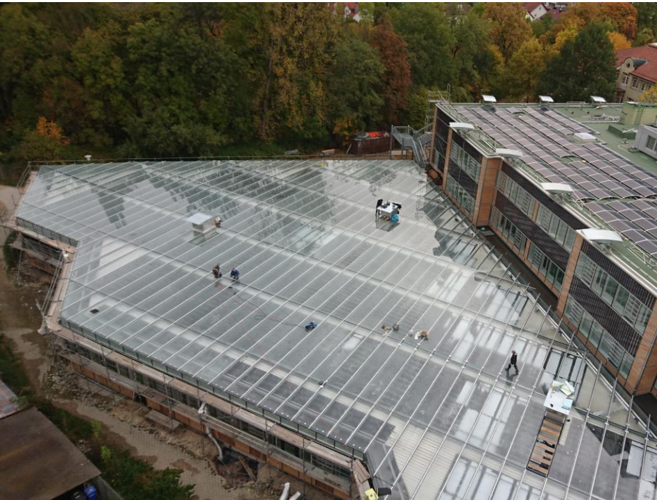
8 mm ESG-Verglasung, 1,5° Dachneigung, keine Entwässerung u. Sicherung
