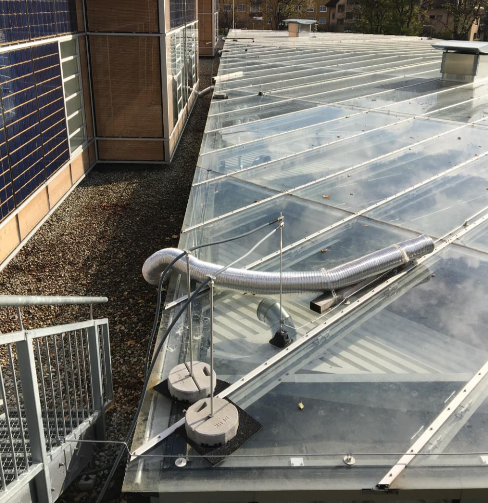
AKD, Kurzschlüsse bei der Prozessluft – Hitzestau und Schäden am Dach
