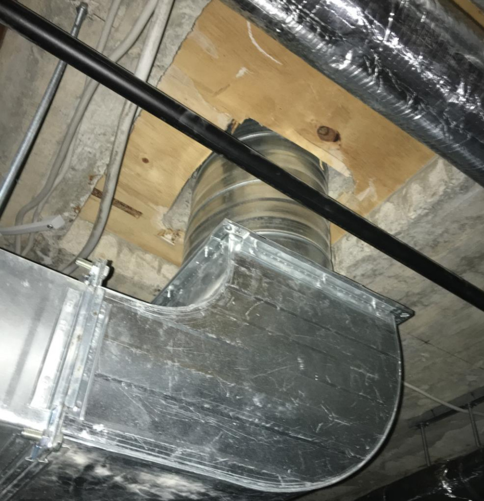
Kriechkeller – Zuluft NwT
