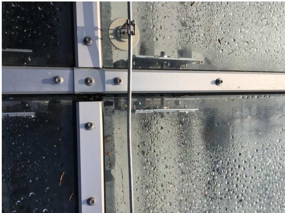
Undichtigkeiten infolge von thermischen Ausdehnungen
