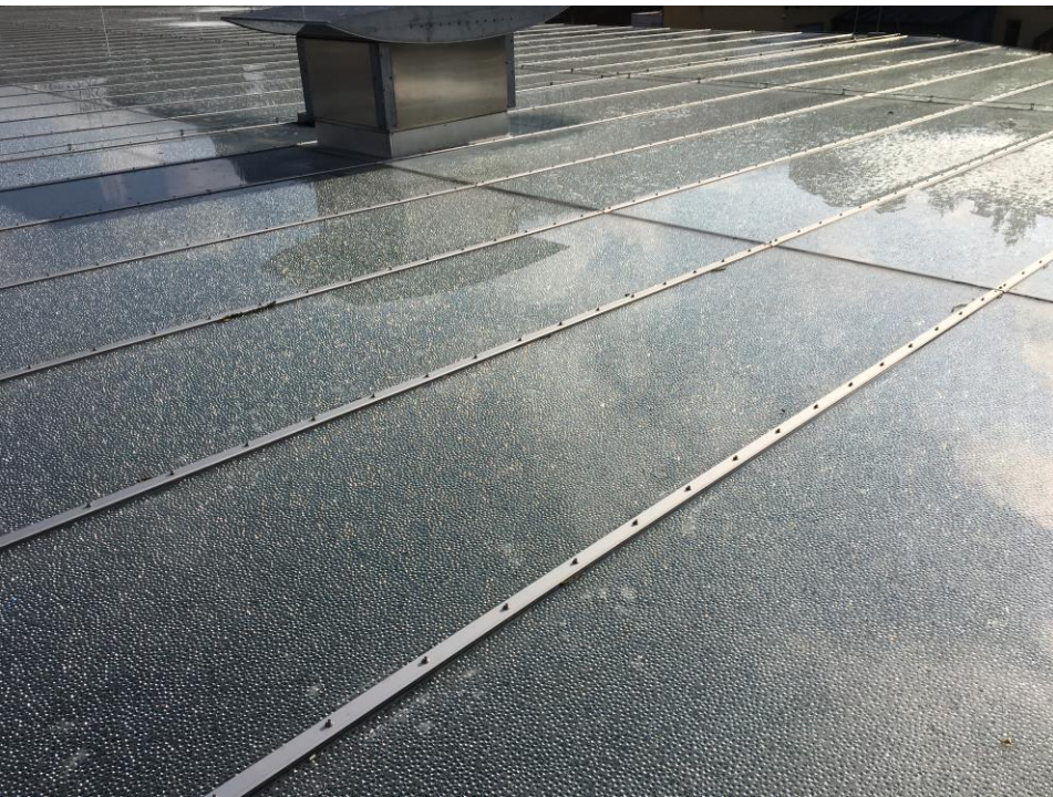
Kondensat bei kühler Außenluft
