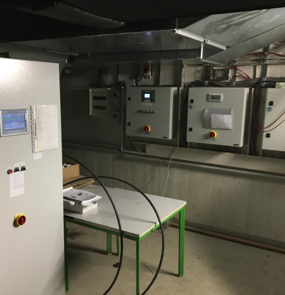
Schaltschränke in der Lüftungszentrale
