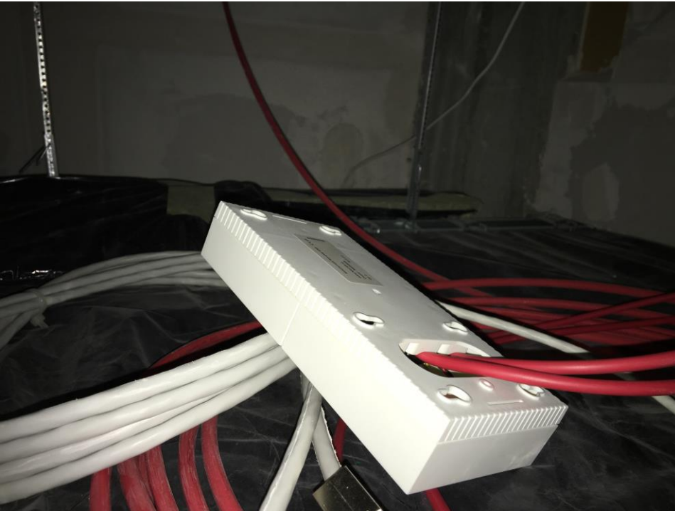
Türsteuerung für einen Brandabschnitt, Raum 206
