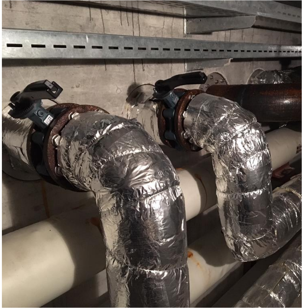
Anschluss Erdsonden – korrodierende Leitungen im Verbindungsgang
