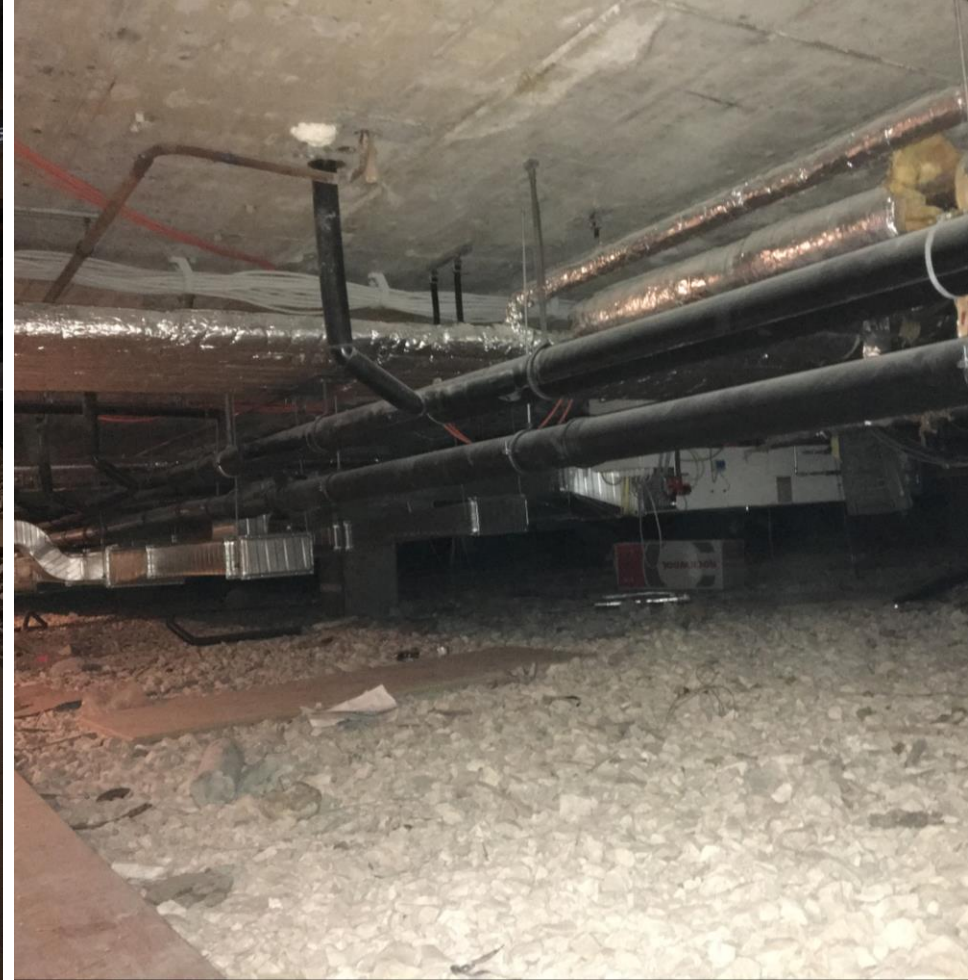
NwT-Bereich, Zugänglichkeit Lüftungsgeräte
