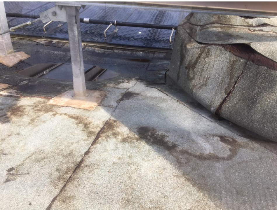
Schäden am Bitumen durch Hitzestau
