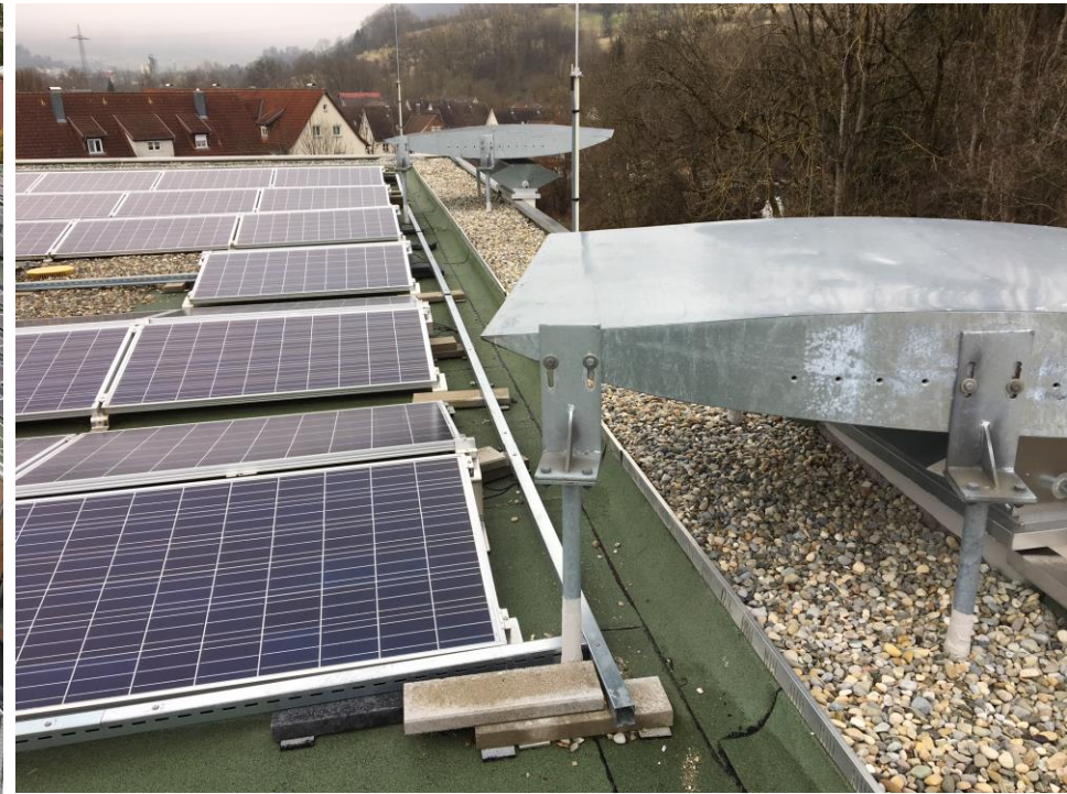
2 m Abstand zur Absturzkante bei Wartungsarbeiten ohne Absturzsicherung
